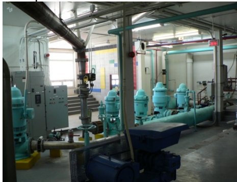
Pompes de distribution
